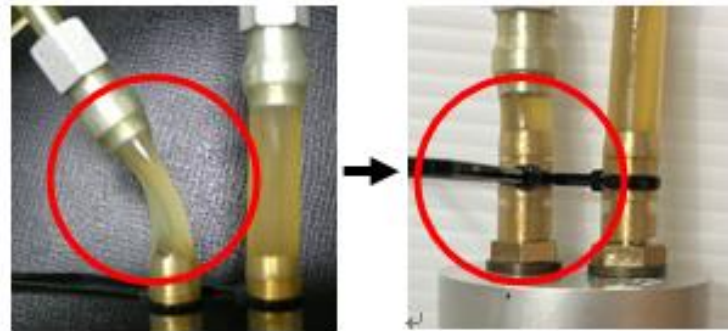
図1 シリコンパイプの凹み
